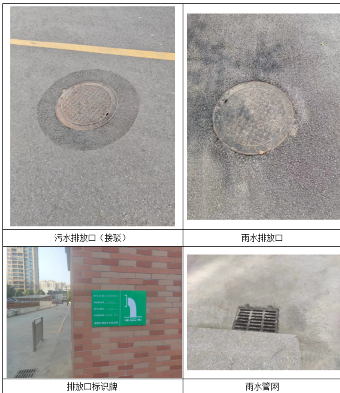
图 3.5-1 院区废水环保处理设施图
